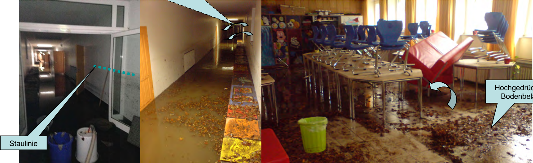
Zulauf durch die eingedrückten Fensterscheiben
