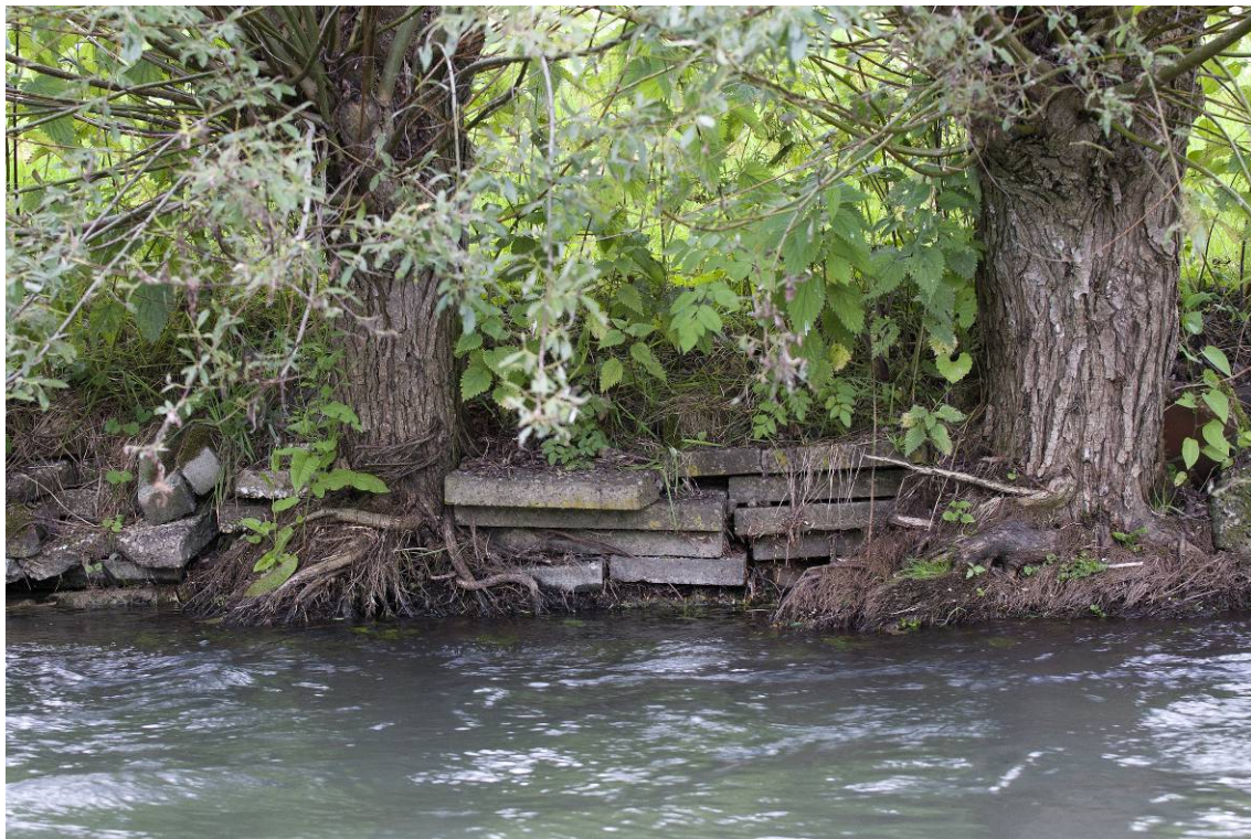
Abb. 24: Wilder Verbau an einem Gewässerabschnitt
