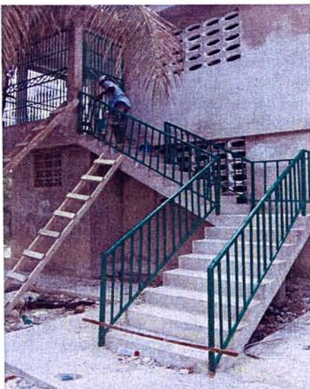
August 2011: Letzte Lackierungsarbeiten werden an der neuen Außentreppe von „Le Renouveau“ durchgeführt.
